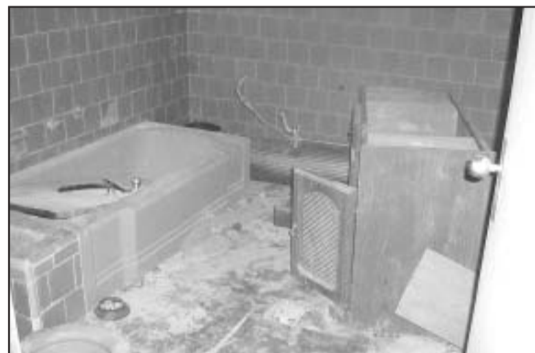
Invasores entraram na sede da fazenda e destruíram cômodos
